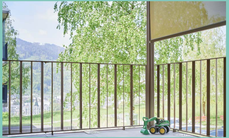
Illustration 6: garde-corps de balcon conforme à la norme
